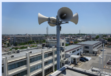
▲防災行政無線（屋外スピーカー）
