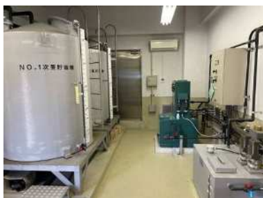
次亜注入機室
