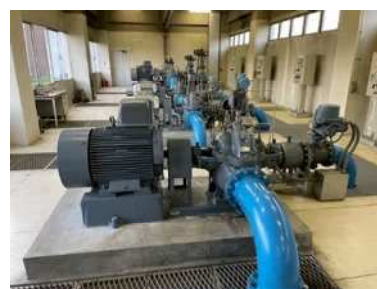
配水ポンプ室
