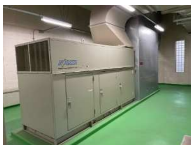
自家発電機室
