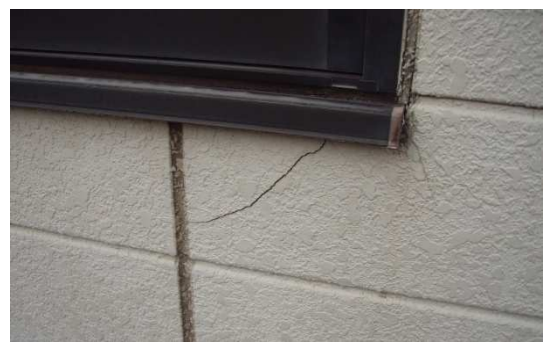
外壁のひび割れ
