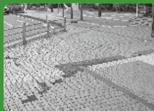
つぎはぎだらけの 杉戸高野台駅西口駅前広場
