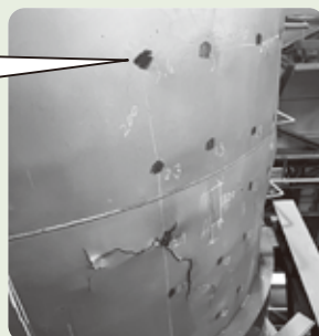
亀裂の入った鉄皮煙道
