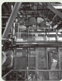
1号流動床式焼却炉 外装
