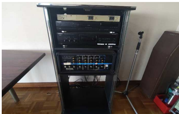
▲ 音響設備 一式
