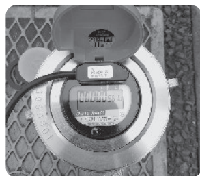
スマートメーター
