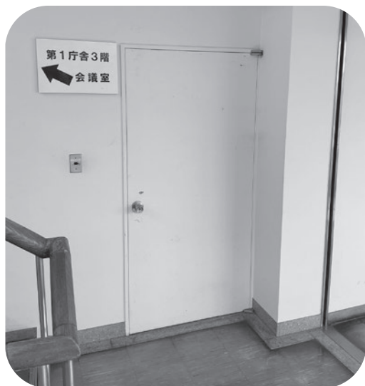
▲ 庁舎内の防火扉と防火シャッター
