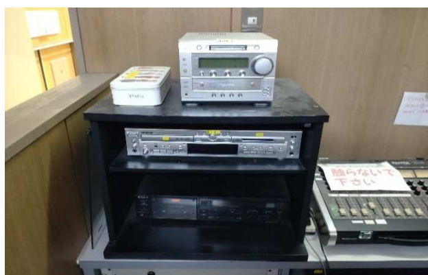
▲ 音響設備 一式
