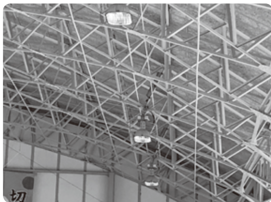
体育館照明器具
