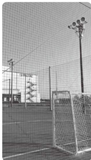
設置された夜間照明
