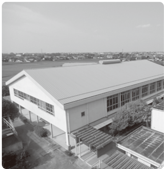
老朽化した広島中学校体育館
