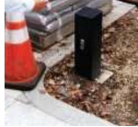
電気取り出し口
