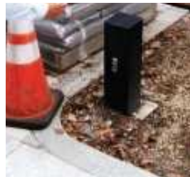
電気取り出し口
