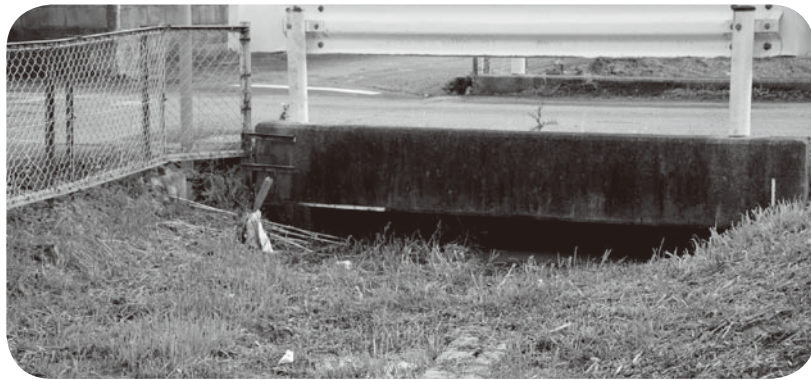
川底があがって橋につきそうな南側水路
