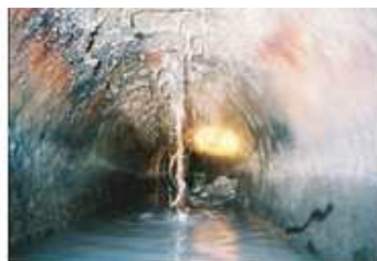
クラックからの侵入水
