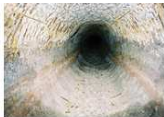
硫化水素による管渠の腐食
