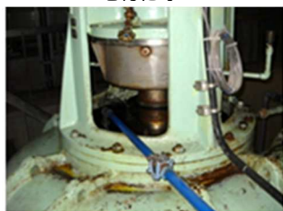
ポンプ本体(内部軸受)の劣化
